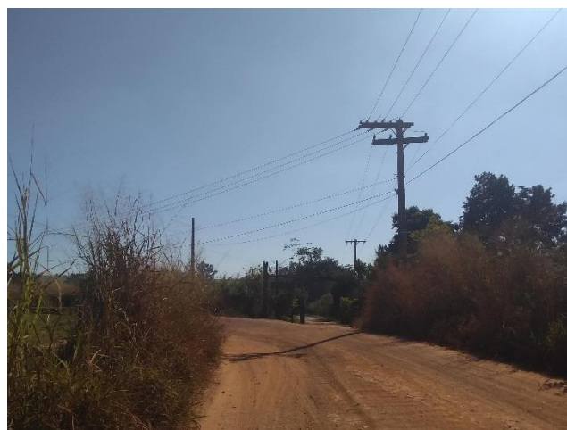
Foto 20 – Posteamto na via de acesso ao empreendimento
